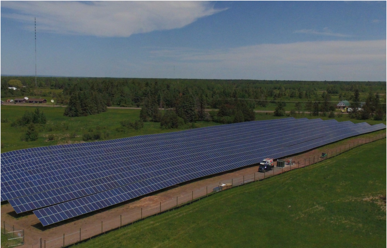
OREDOCK 📍 WI ⚡ 1.00 MWdc
